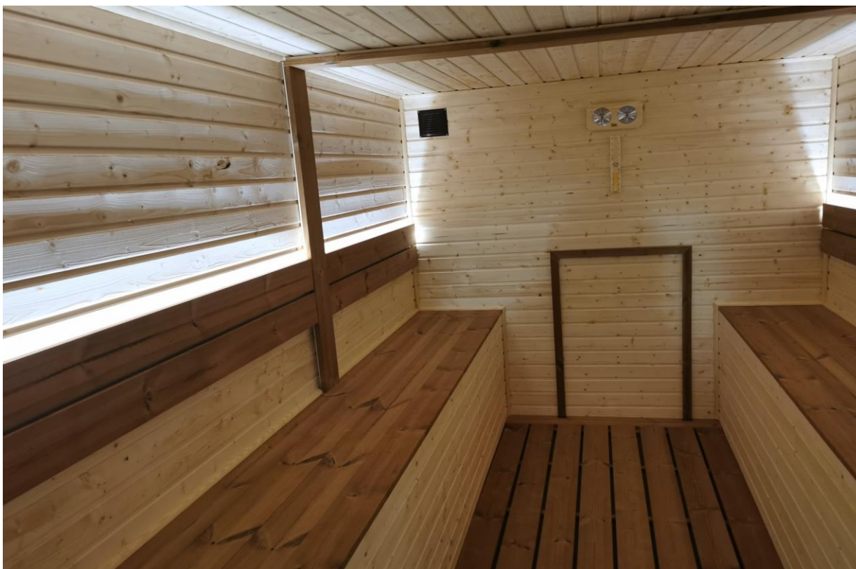
Modernizacja Hali Sportowej. Sauna fińska na Hali Sportowej
